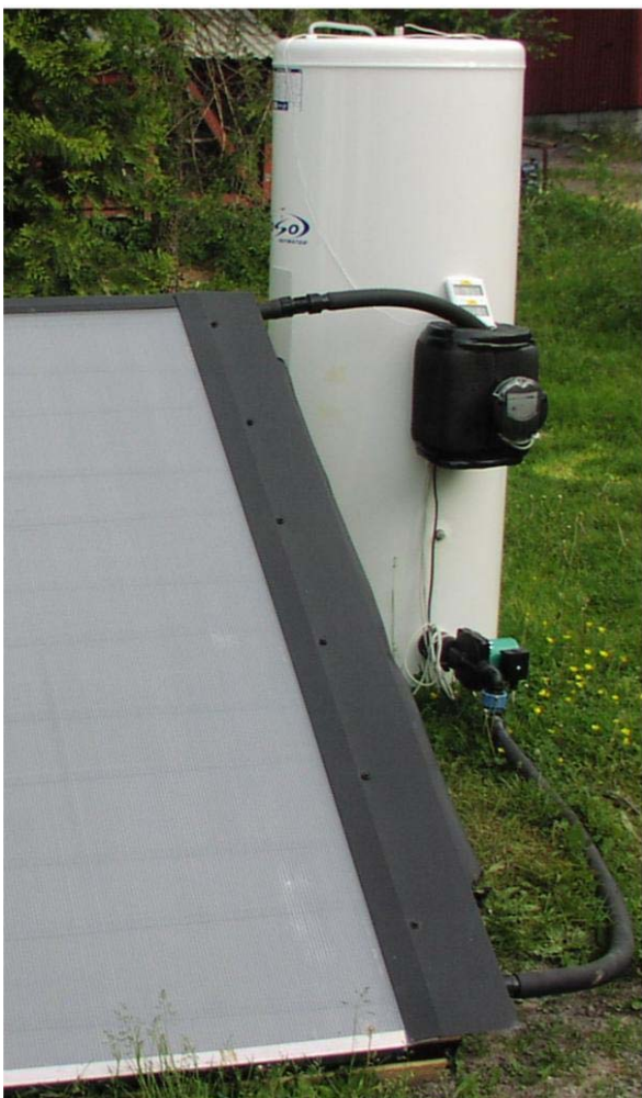
Bildet: Standardisert tappevanns solvarmeanlegg under utvikling i samarbeid med OSO Hotwater. (Nærmere beskrivelse kommer i senere Solgløtt.)
