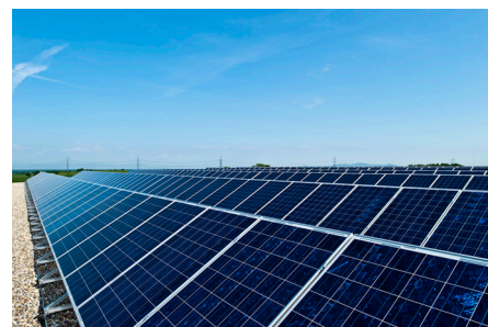
Solcellepaneler i bruk til strømproduksjon for distribusjon på elektrisitetsnettet (REC)
