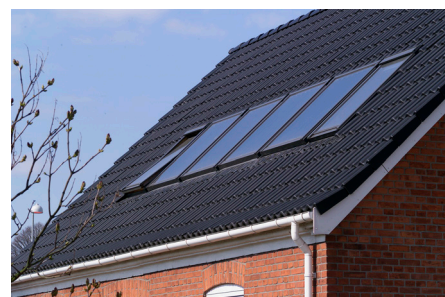
Solfangere installert på tak for lokal varmtvannsproduksjon (VELUX/ESTIF)
